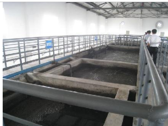
生活污水处理设施
